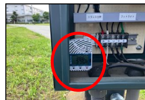
温度計を設置して盤内温度を計測
