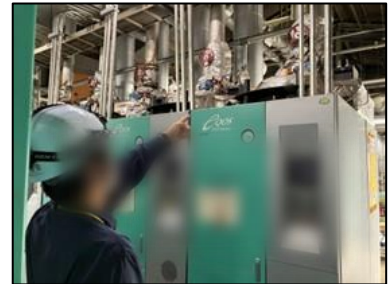
ボイラ燃焼状態確認
