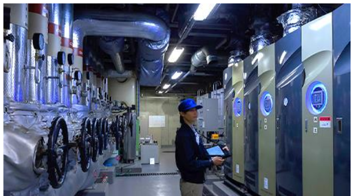
高効率機器のマシンルーム
