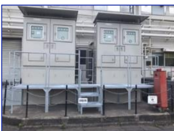
電気設備の高上げ洪水対策
