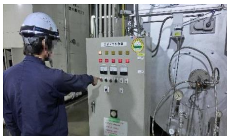
灯油漏洩を想定したボイラー緊急停止
