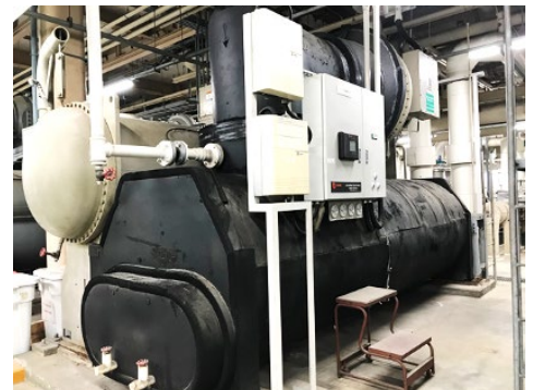
高効率冷凍機
