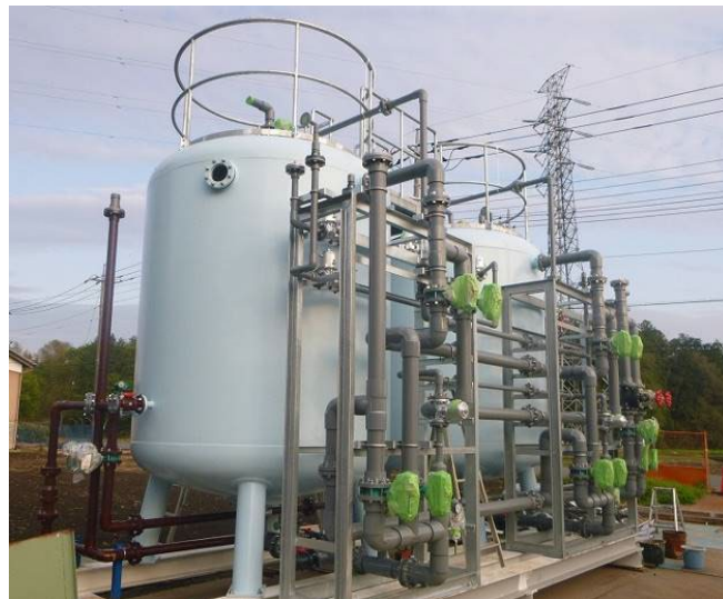
ホウ素排水処理設備
