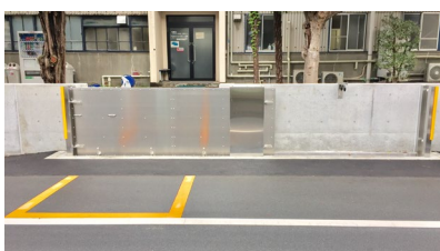
多摩川の氾濫を想定した止水門
