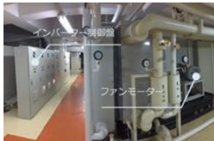
循環空調機へのインバーター制御導入
