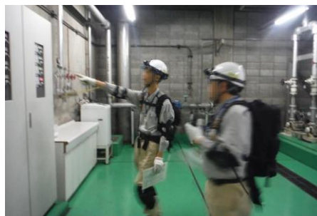
大規模地震訓練での熱源設備停止訓練
