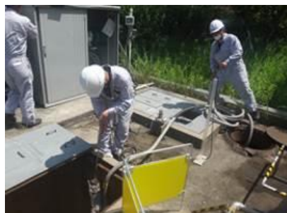
浄化槽の異常想定訓練
