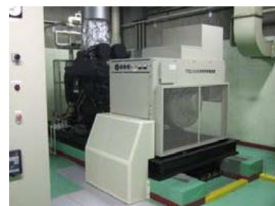
高効率の自家発電装置への更新
