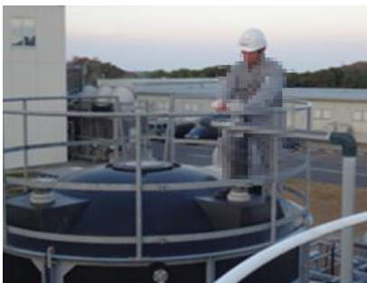
タンクからの薬品漏えい想定訓練
