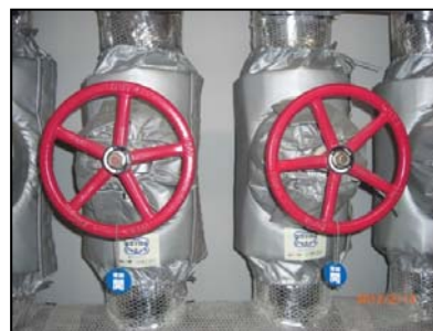
エコクロスジャケットを装着した蒸気配管バルブ
