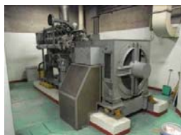
整備前の自家発電機
