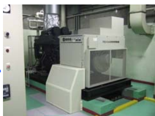
オーバーホールした自家発電機
