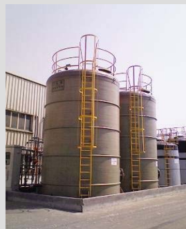
BF 4 常温分解槽
