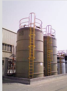
BF 4 常温分解槽
