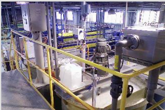
凝集沈殿処理(BF 4 分解後)
